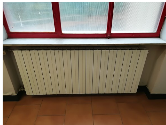
Figura 4.7 – Particolare dei ventilconvettori
